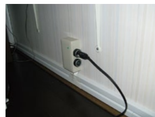
直流電源専用コンセント
