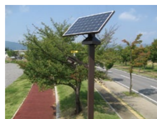
湖畔のジョギング道を照らすソーラー街灯に
