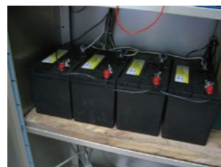
バッテリーに蓄電中
